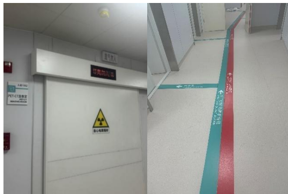
机房门外警示标识、工作状态指示灯、地面导流标识
